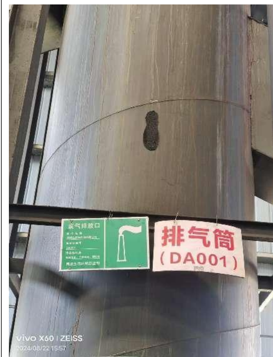
废气排放口 (DA001)
