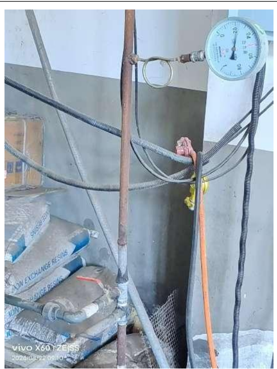
炉内脱硝系统2
