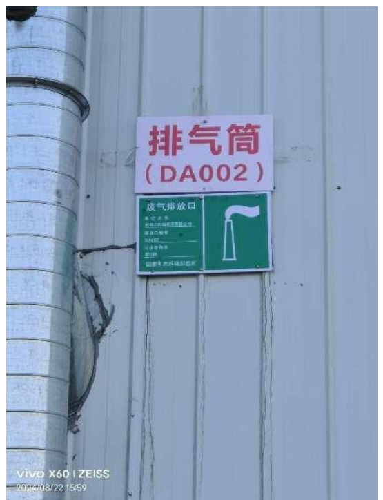
废气排放口 (DA002)
