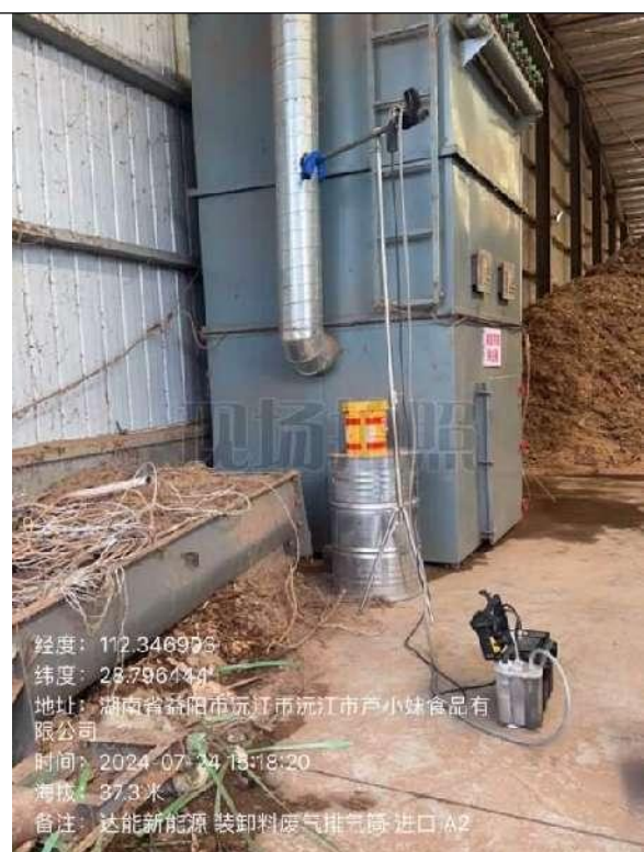
装卸料废气排气筒进口
