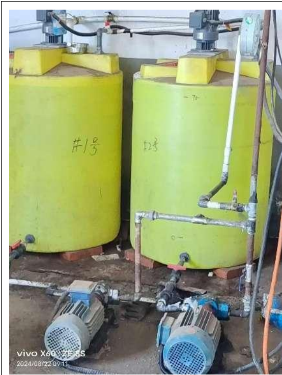
炉内脱硝系统1
