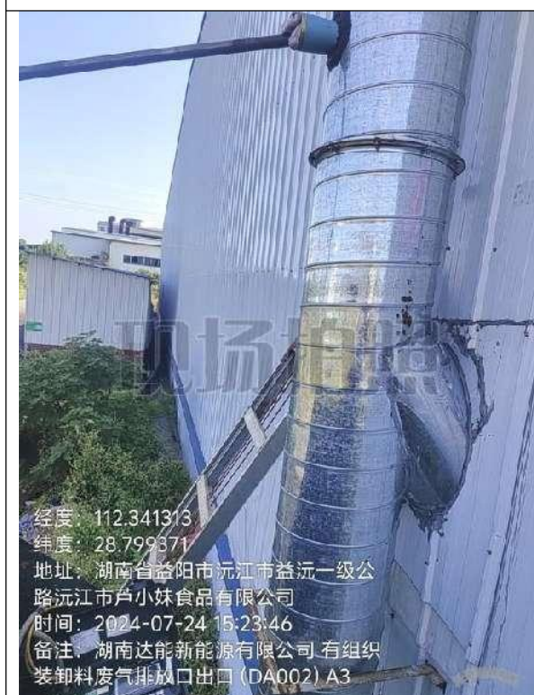
装卸料废气排气筒
